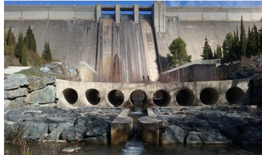
Presa de Siurana_río Siurana_Canaleta Parshall
